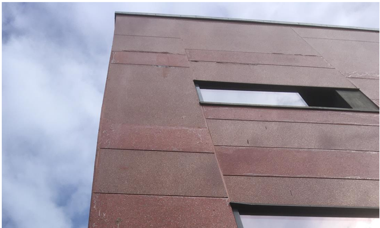
Illustrasjon 3 Stavanger konserthus. Fra befaring 2022. Skader på betongen
