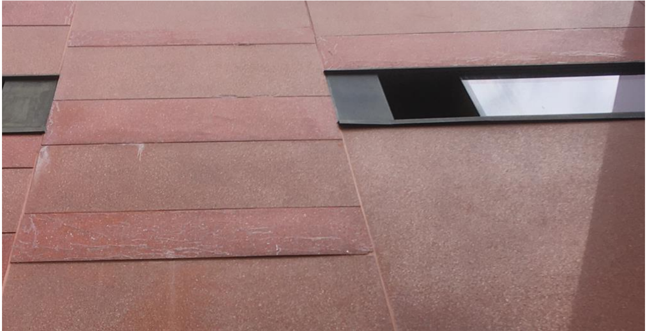
Illustrasjon 4 Stavanger konserthus. Fra befaring 2022. Skader på betongen
